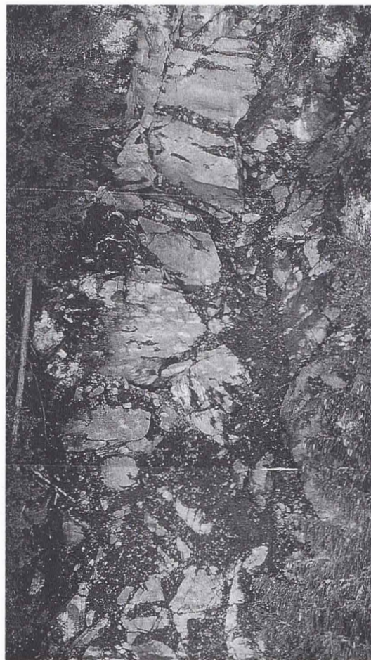
Wasser tritt teilweise aus Spalten. Es besteht die Gefahr weiterer, auch grösserer Abbrüche.
